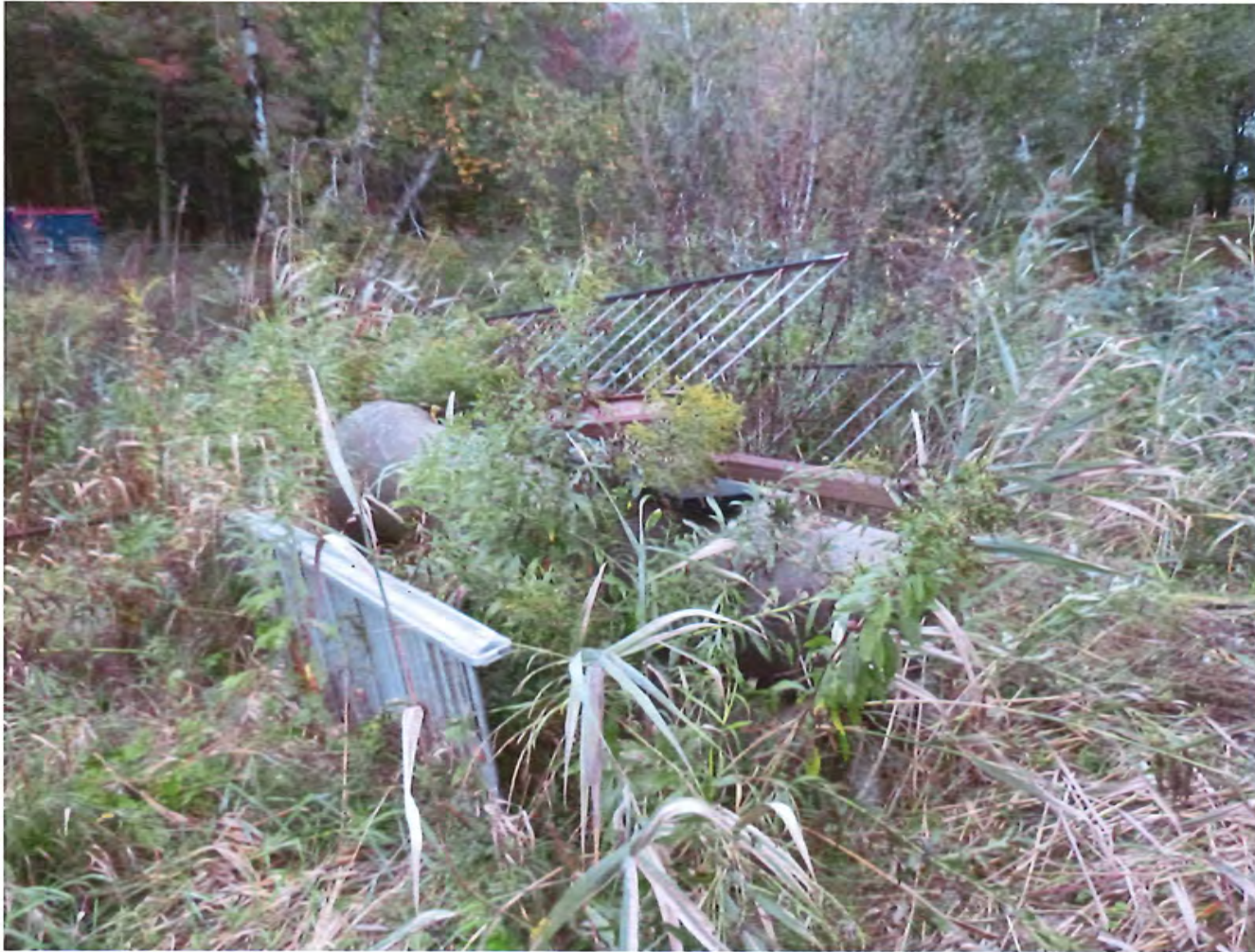
Photo 12 : Ponceau et pièces de métal.
