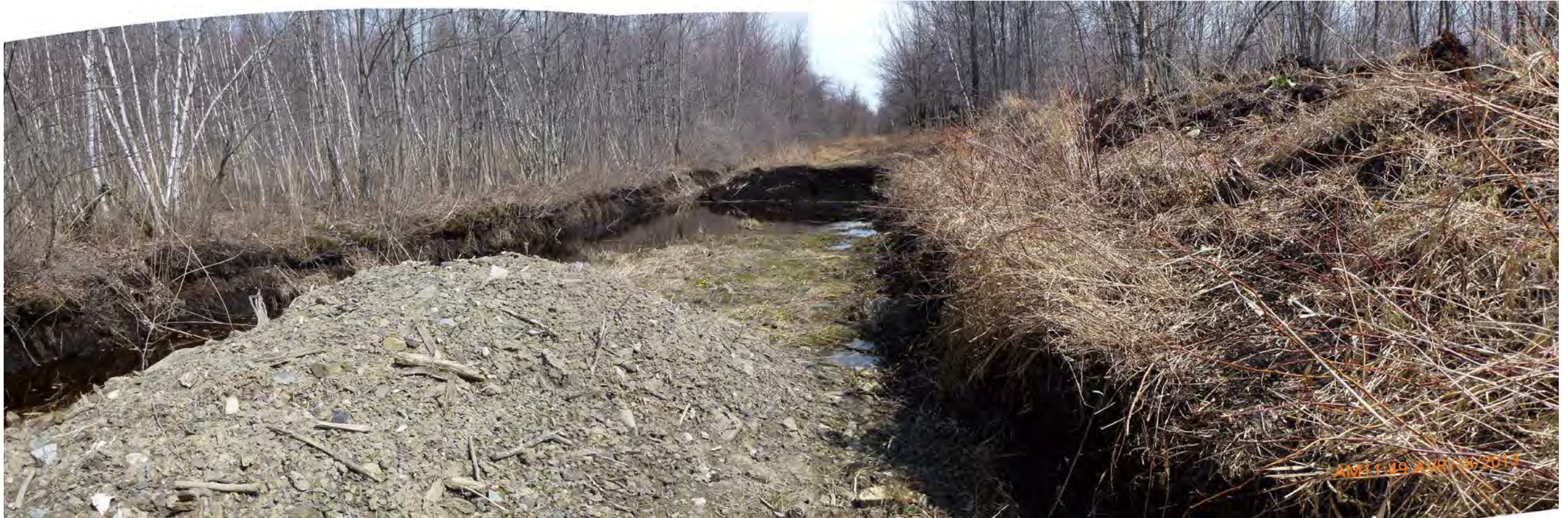
SITE EXTRACTION DE TERRE ET REMPLISSAGE AVEC PIERRES ET DÉBRIS EXOGÈNES
