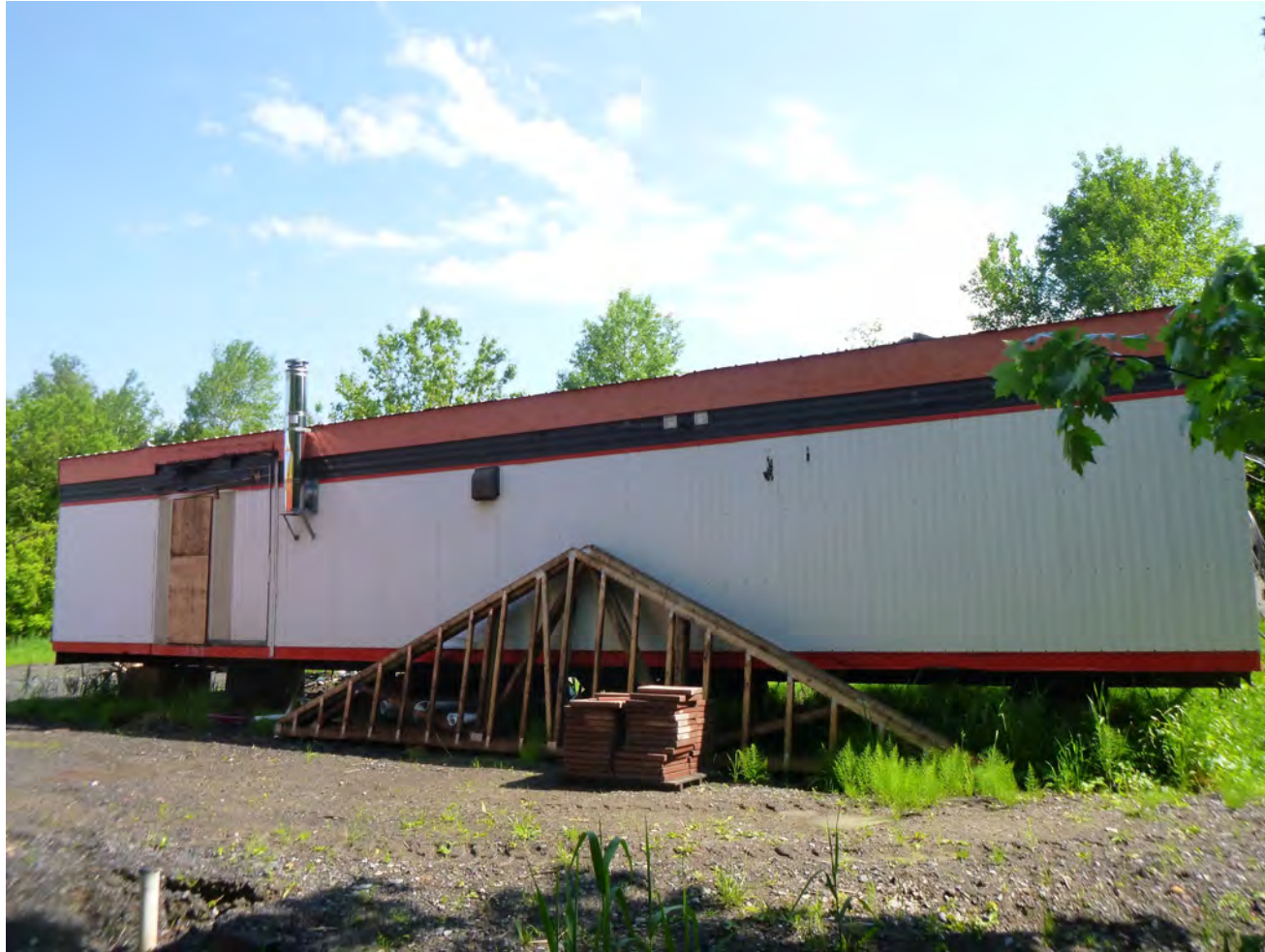
Photo 12 : toit de ferme et dalles.
