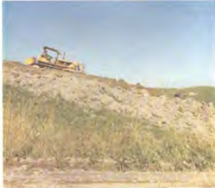
Le planage des pentes est le plus souvent une pratique condamnable.
