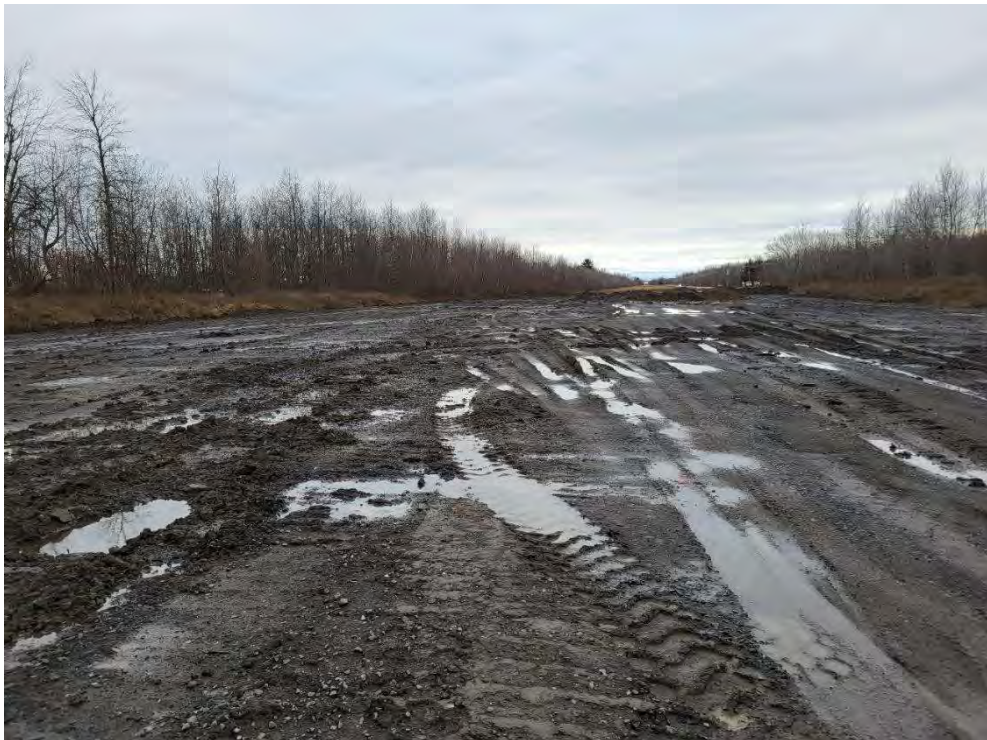
Photo 24 : Remblai en cours dans la section nord du champ, vue en direction sud-ouest
