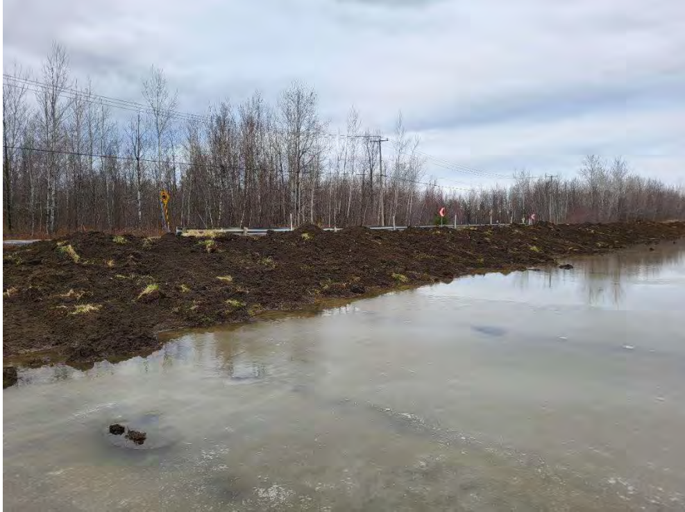
Photo 15 : Terrain naturel excavé pour le remblai et berme de sol arable, vue en direction nord
