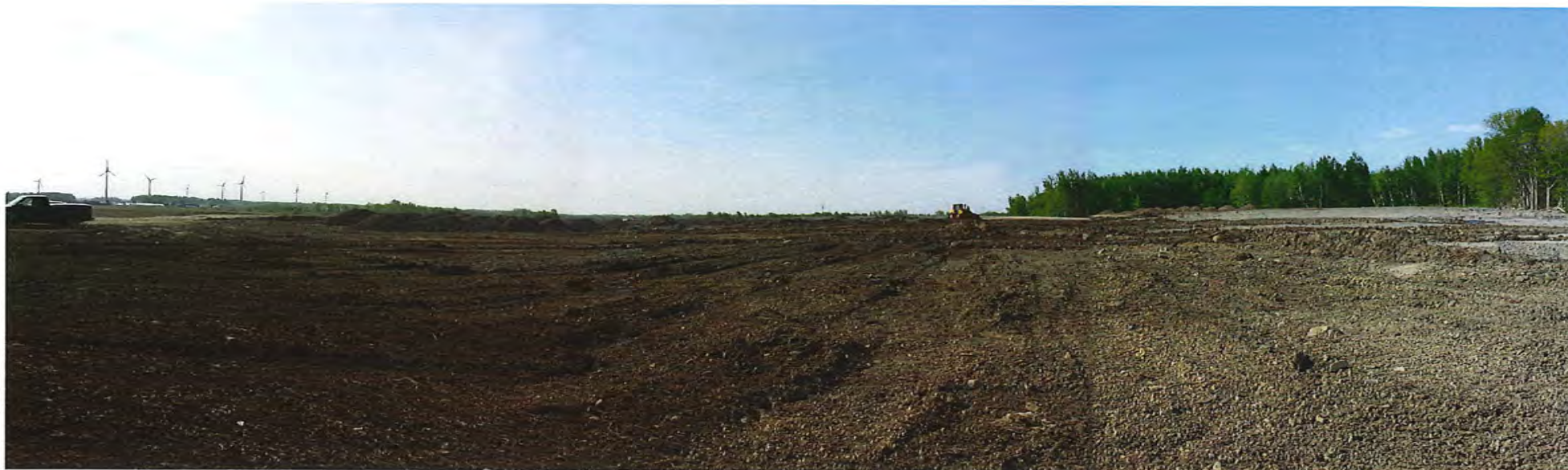
Photo 33 : Remblai étendu lors de la visite
