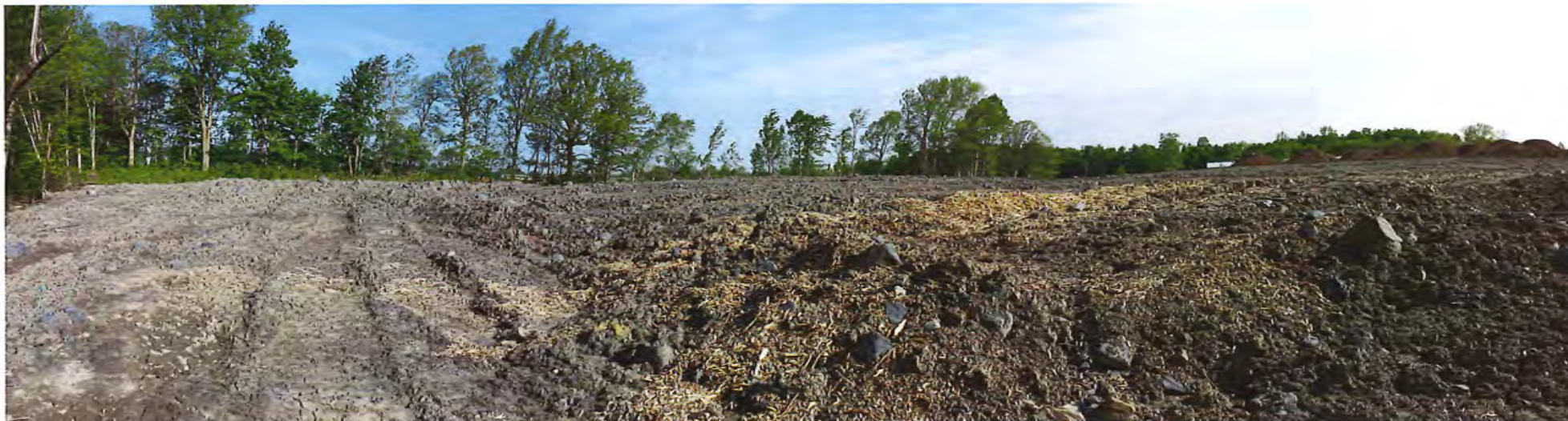
Photo 24 : Matériau terreux dans le remblai
