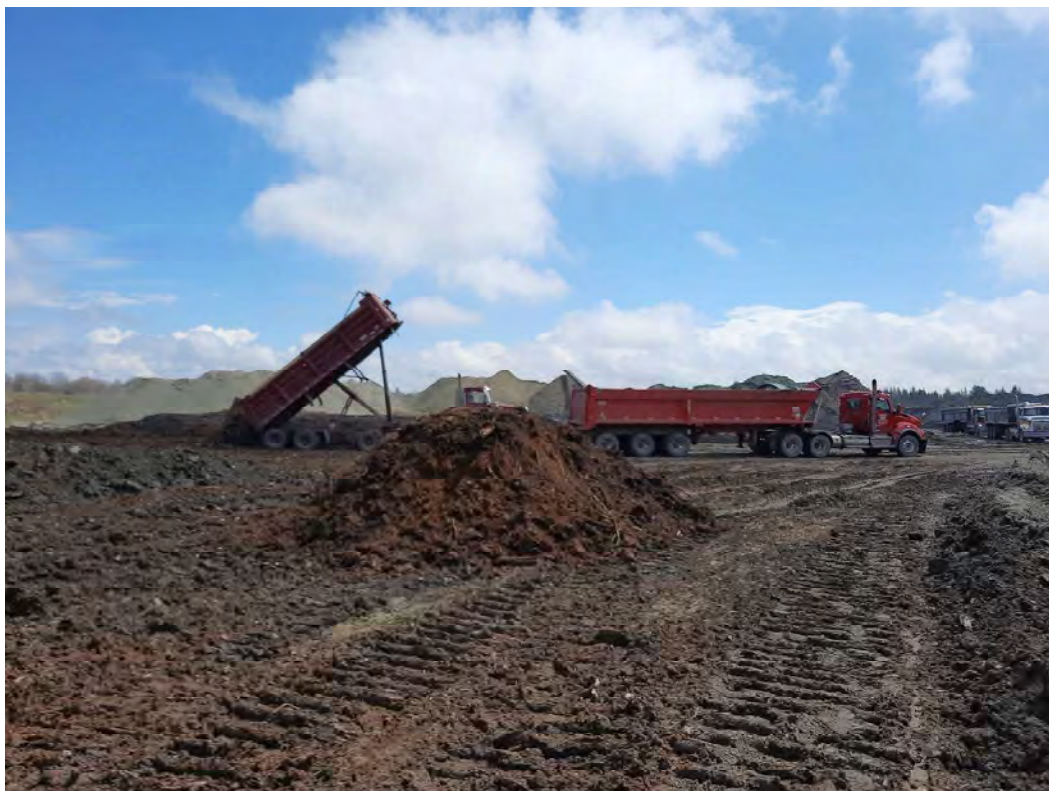
Photo 1. Deux camions en attente pour décharger du matériel de remblai, un en train de reculer et l'autre en train de décharger son chargement.
