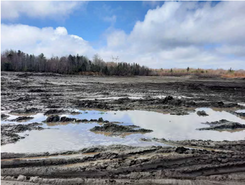
Photo 2. Superficie remblayée avec plusieurs traces de passage de camions. On constate un mauvais drainage de surface.
