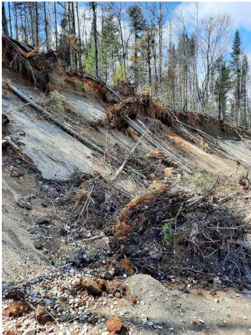
Photo 9. Sol arable mal décapé tombant dans l'exploitation. Arbres déracinés tombant dans l'exploitation.
