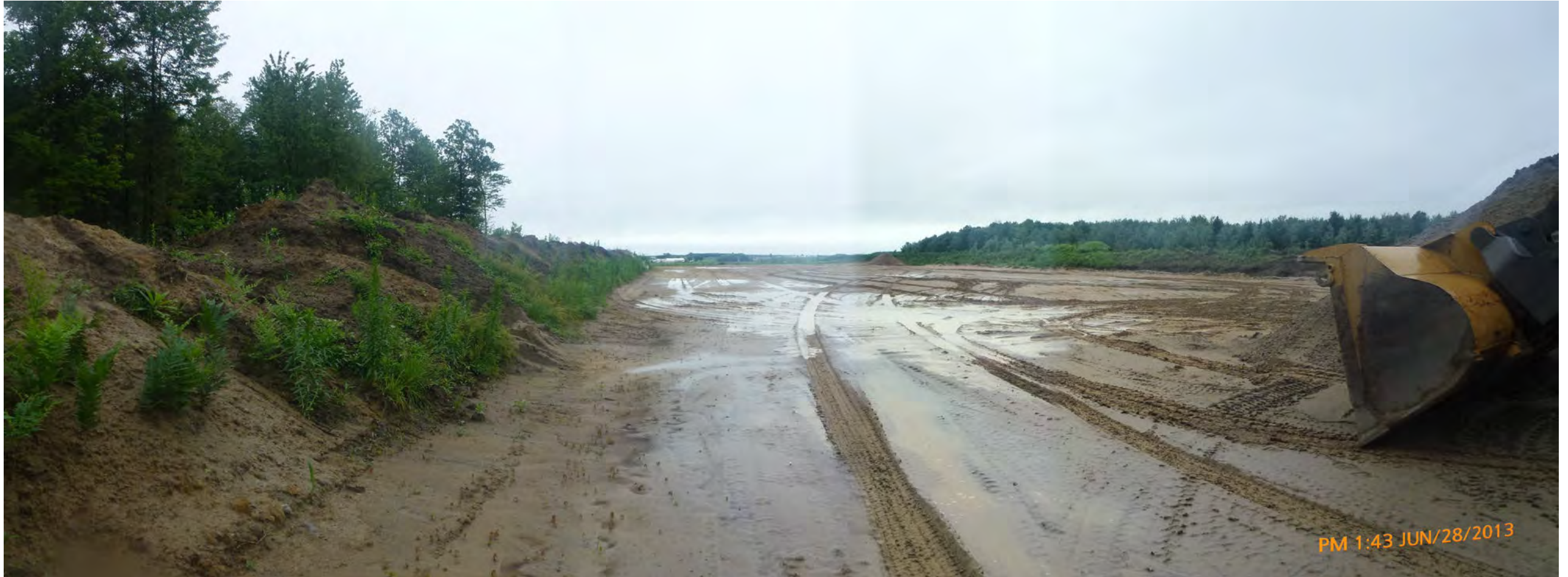
Vue vers le sud-est. Sol arable conservé en andains à gauche et fond d'exploitation nivelé, prêt pour remise du sol arable.
