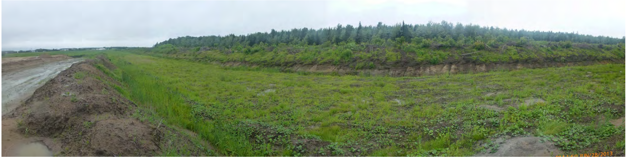
Troisième planche (la plus à l'ouest), prête pour remise du sol arable, conservé en andains de part et d'autre.
