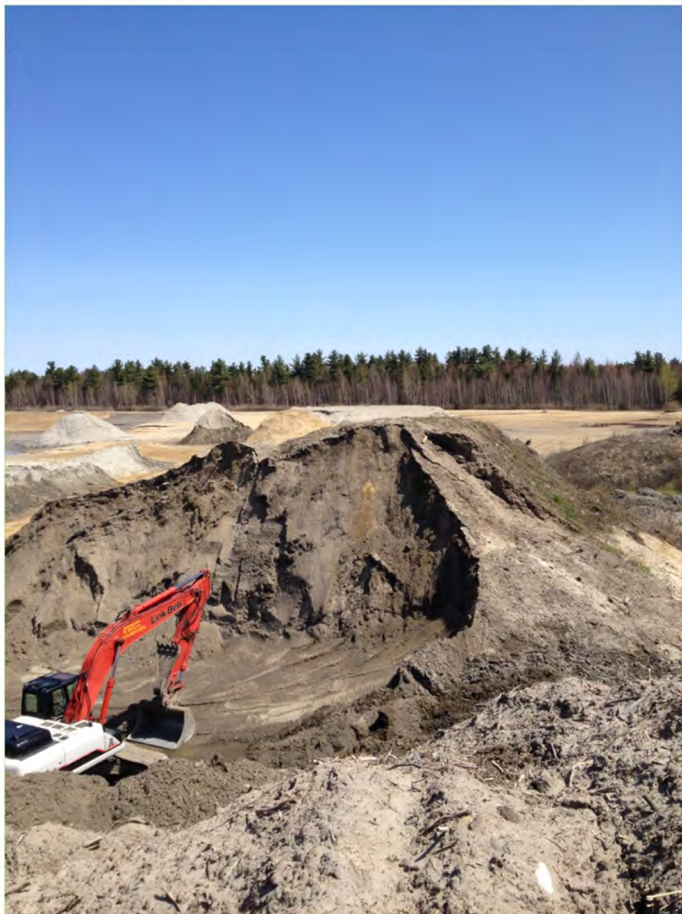
Zone de production du terreau.
