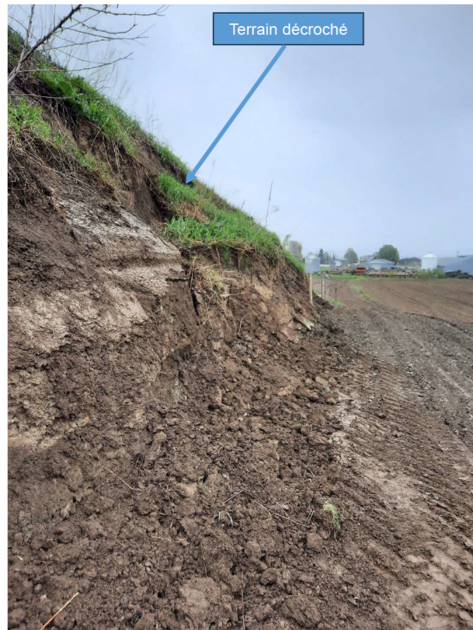
Photo 5. Talus abrupt sur la limite de lot avec signe de décrochage
